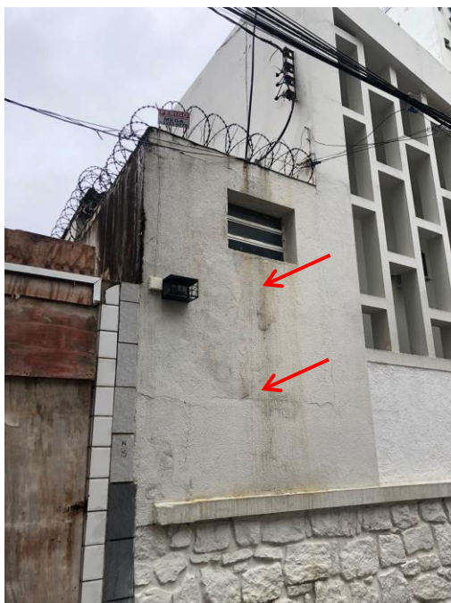
Foto 9: Trincas causadas pela umidade excessiva.
