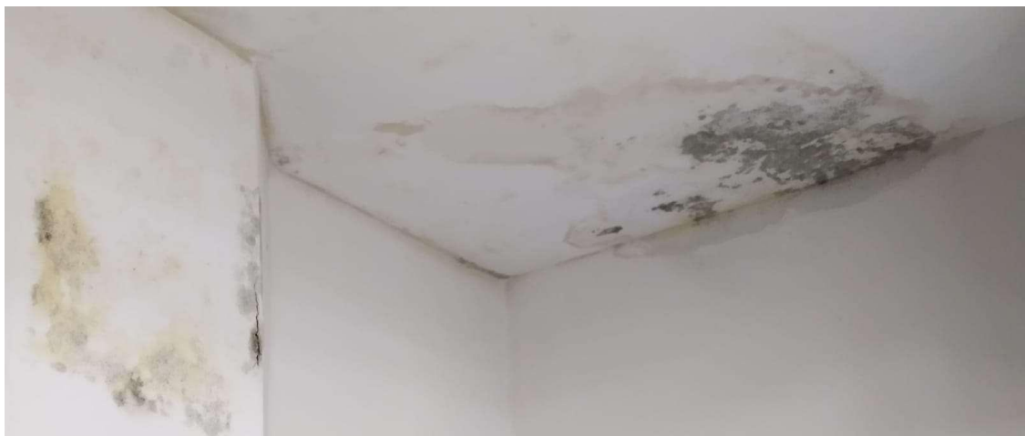
Foto 8: infiltração nas paredes e lajes devido a falta de impermeabilização do muro de divisa.
