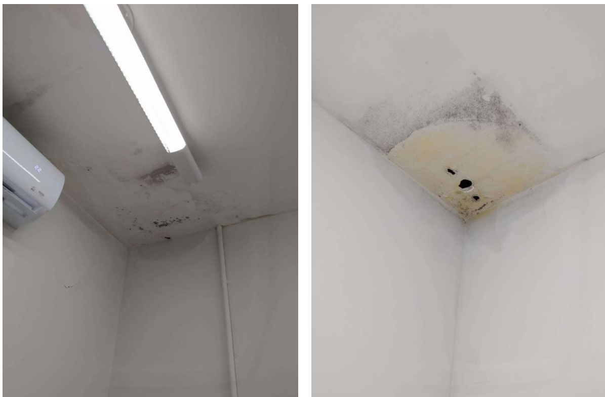
Foto 16 e 17: Infiltração no gesso e paredes do setor de compras.
