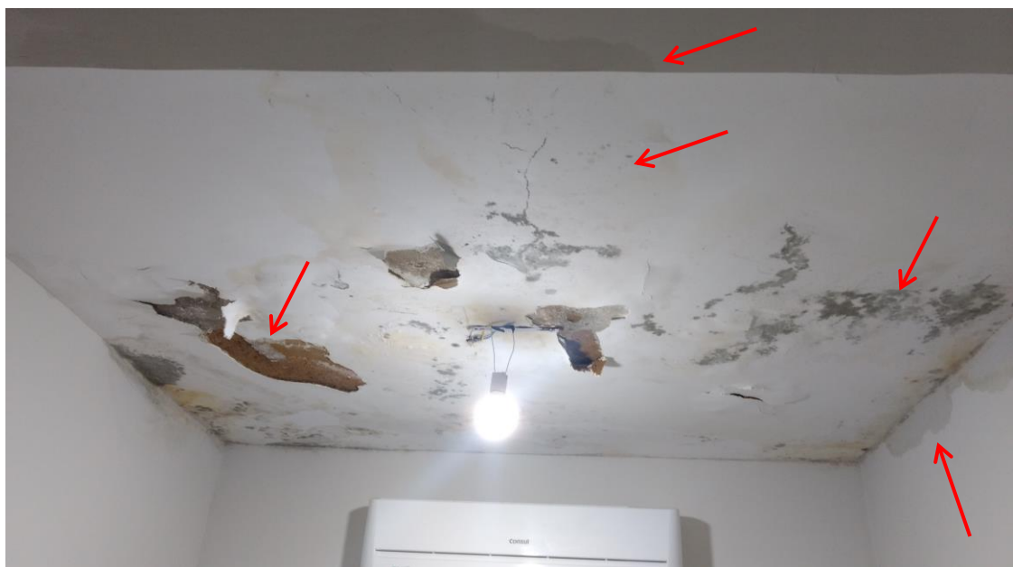
Foto 2: Manchas de infiltração, bolor e decolamento da pintura na laje da taquigrafia.
