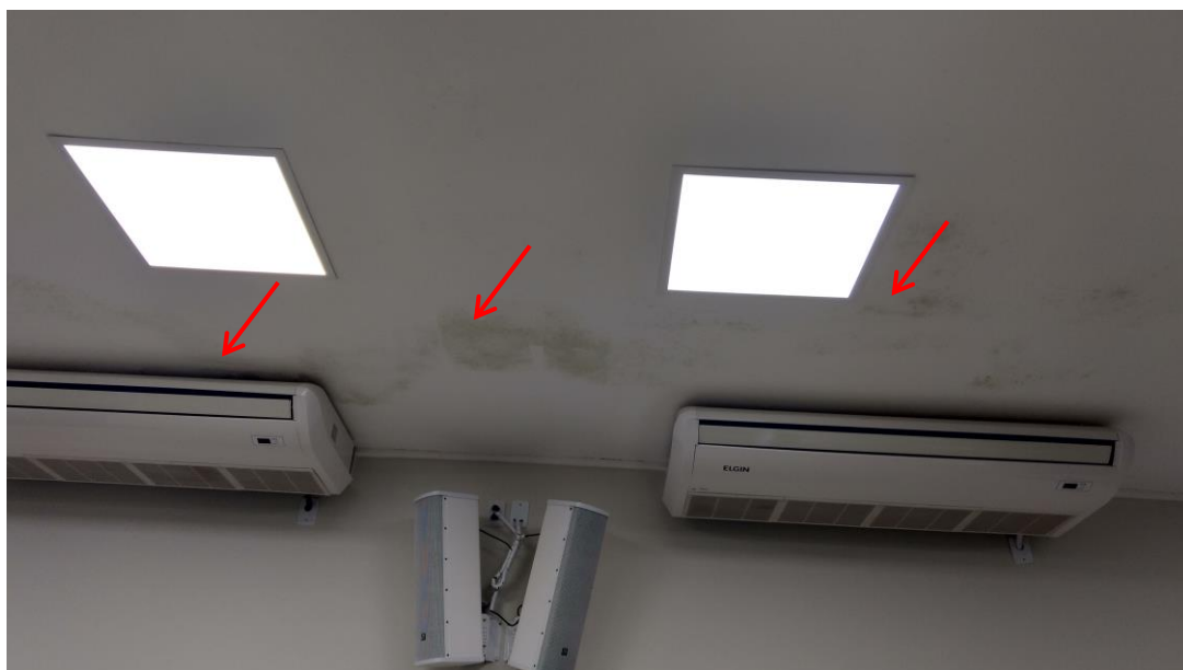
Foto 13: Manchas de umidade e mofo no forro de gesso do plenário.
