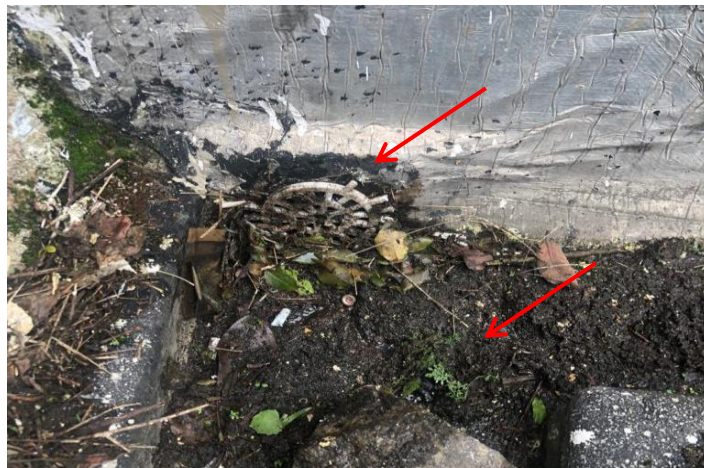
Foto 7: Ralo de escoamento das águas pluviais do terreno dos fundos, completamente obstruído.
