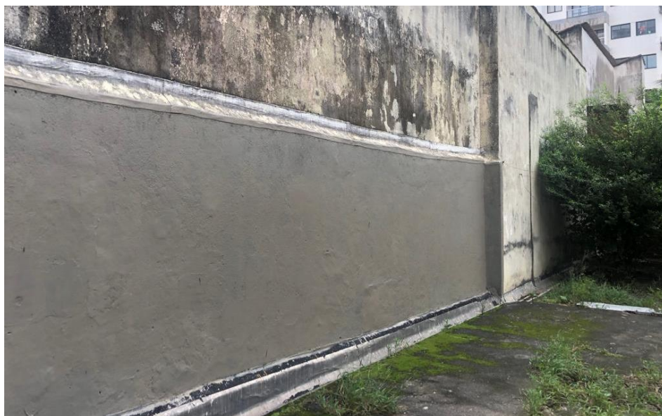
Foto 3: Incidência da água pluvial diretamente no muro de divisa.
