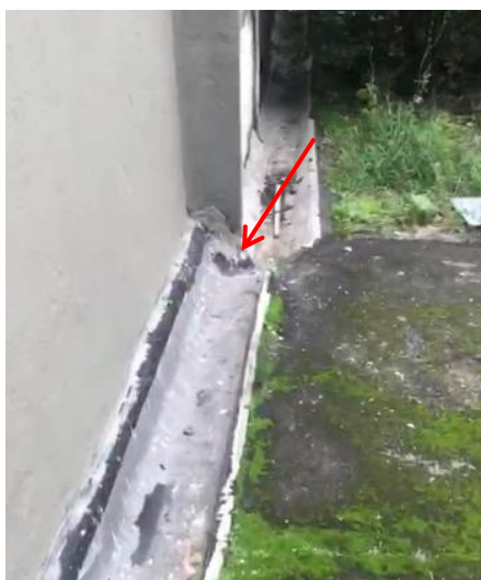
Foto 5: Local de empoçamento de água devido a inclinação errada da calha.
