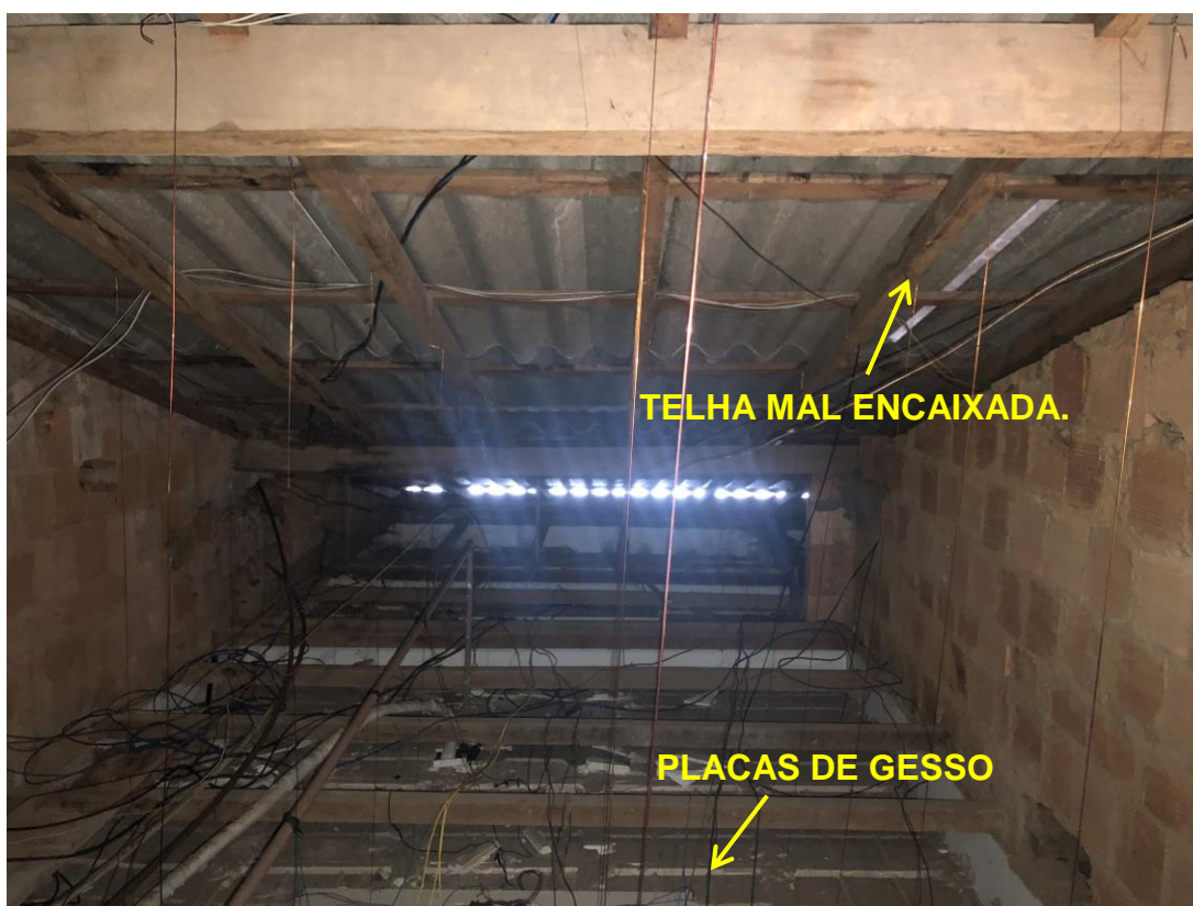
Foto 18: Abertura entre as telhas causando infiltração no gesso.
