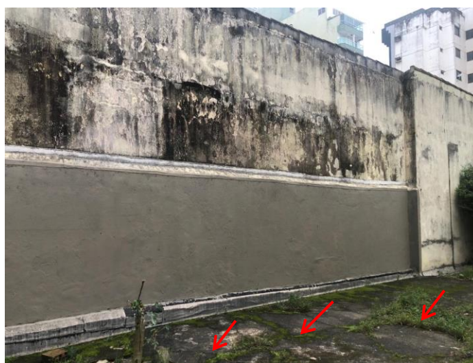
Foto 6: Solo em contato com muro desprovido de impermeabilização no terreno vizinho (fundos).
