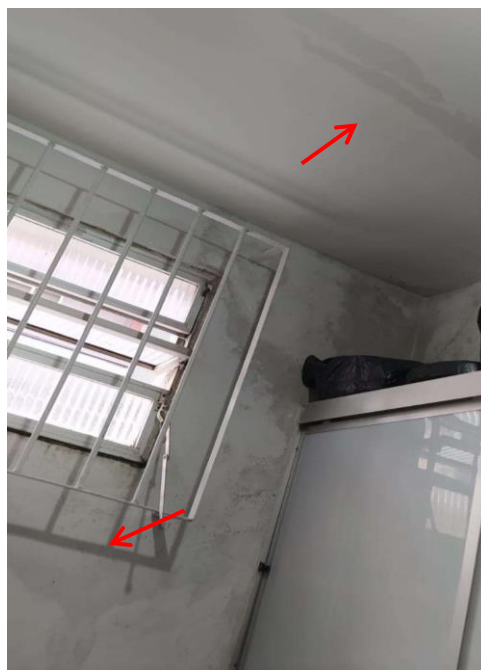
Foto 10: Manchas de infiltração na cozinha.
