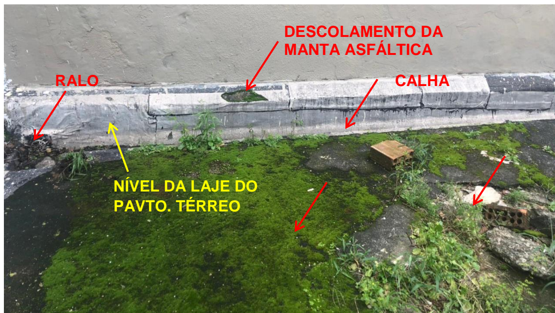
Foto 4: Calha com descolamento de manta impermeabilizante, ralo obstruído e diversas aberturas no pavimento
