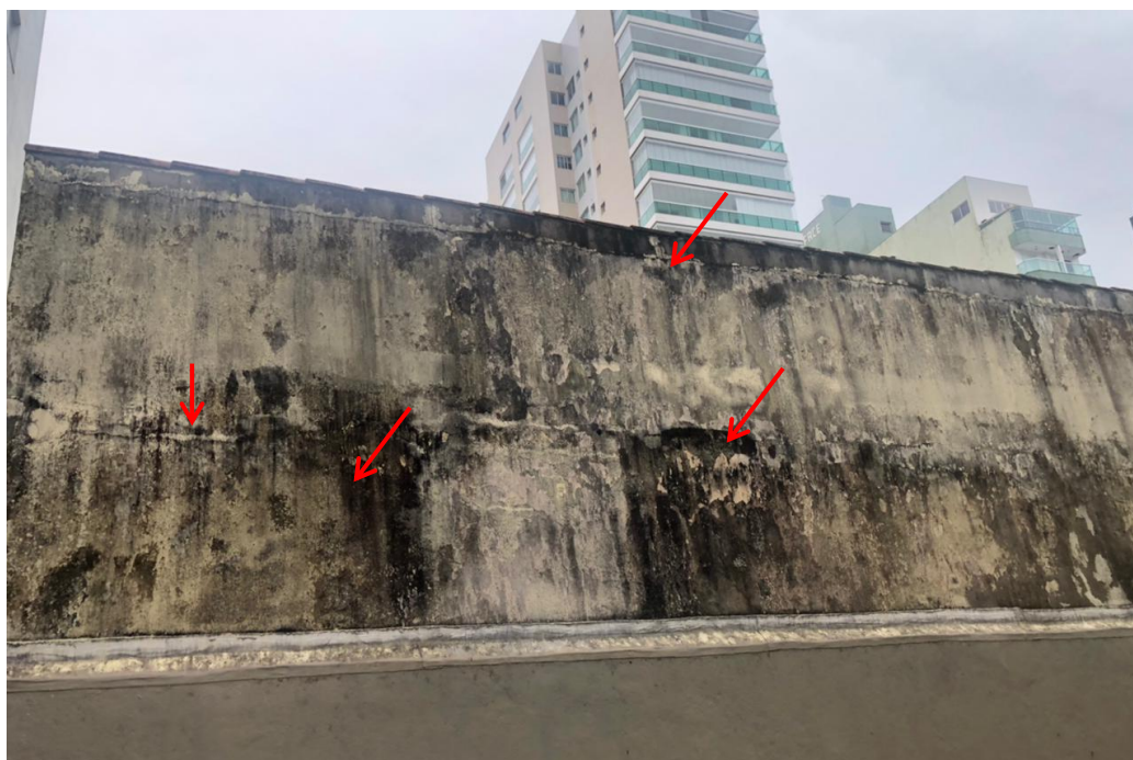
Foto 12: Parede externa das salas da presidência, recepção, diretoria, procuradoria, copa e banheiro. Trincas, mofo, descolamento da pintura e eflorescências causadas por umidade excessiva.
